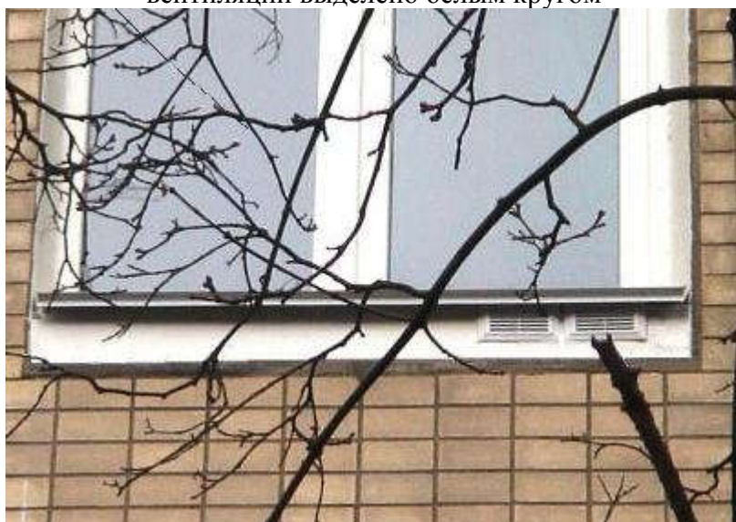
Рис. 9 Фрагмент фасада жилого дома. Приточная и вытяжная решетки окна с функцией рекуперативной вентиляции
