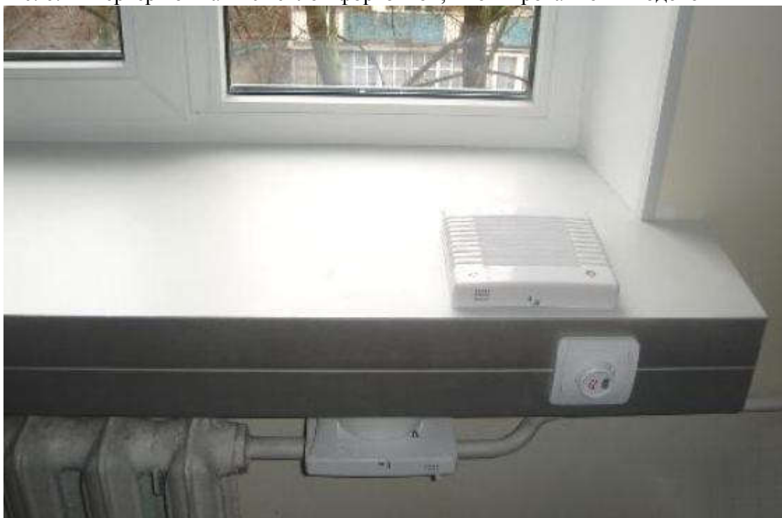
Рис 7. Фрагмент подоконника с приточной (вверху) и вытяжной (внизу) решетками и встроенным диммером (в вертикальной плоскости подоконника)
