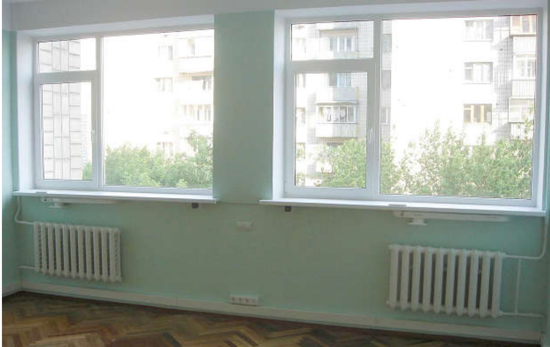
Рис. 1 Вид на герметичные окна со встроенными в подоконники аппаратами ТеФо
