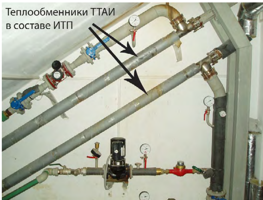
Фото 3. ИТП (блок ГВС) размещен под лестничным пролетом.
