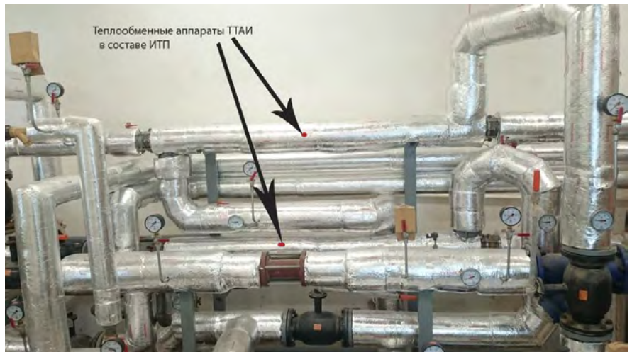
Фото 1. ИТП с теплообменниками ТТАИ.
