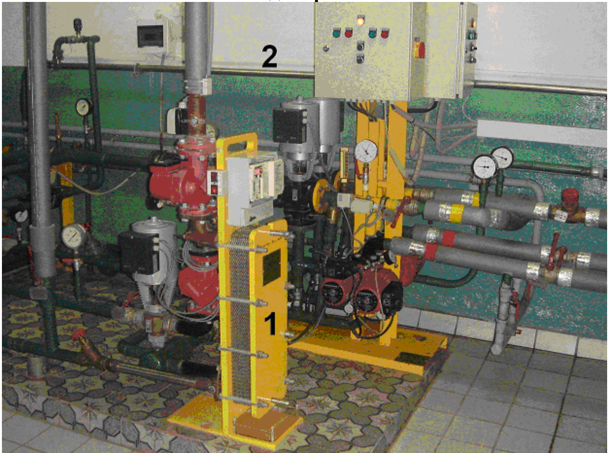
Это – фрагмент теплового пункта общежития КиевЗНИИЭП
